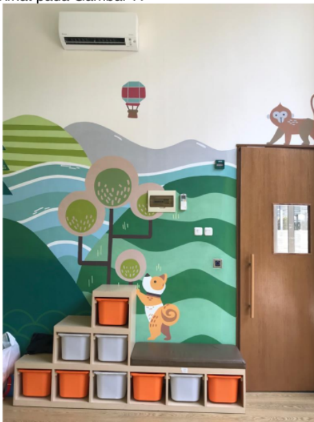
Gambar 7. Perletakan AC Sumber: Dokumentasi Pribadi
